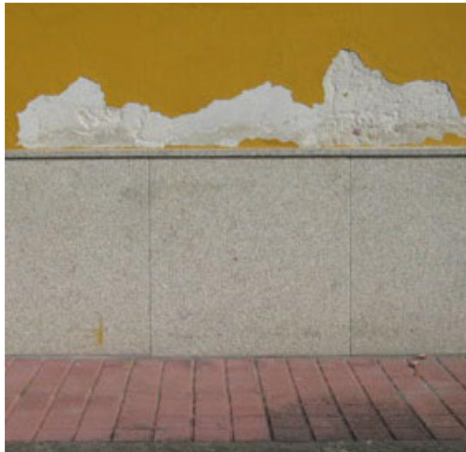
Humidités par capillarité cachés par une plinthe de pierre, qui provoque que l'humidité continue à remonter et réapparaisse par-dessus le niveau de la plinthe.
