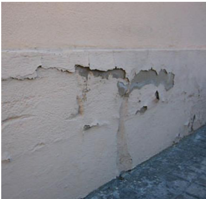
Humidités par capillarité sur le mur d'un logement.
